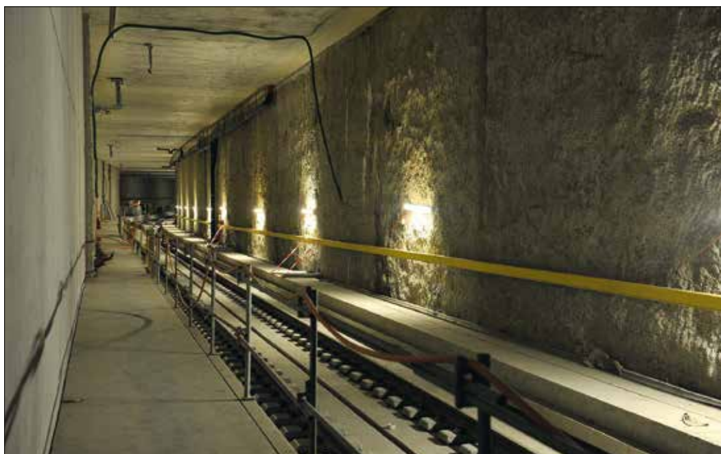
L'une des deux voies Ceva en cours d'équipement aux abords immédiats de la gare des Eaux-Vives (octobre 2018).
