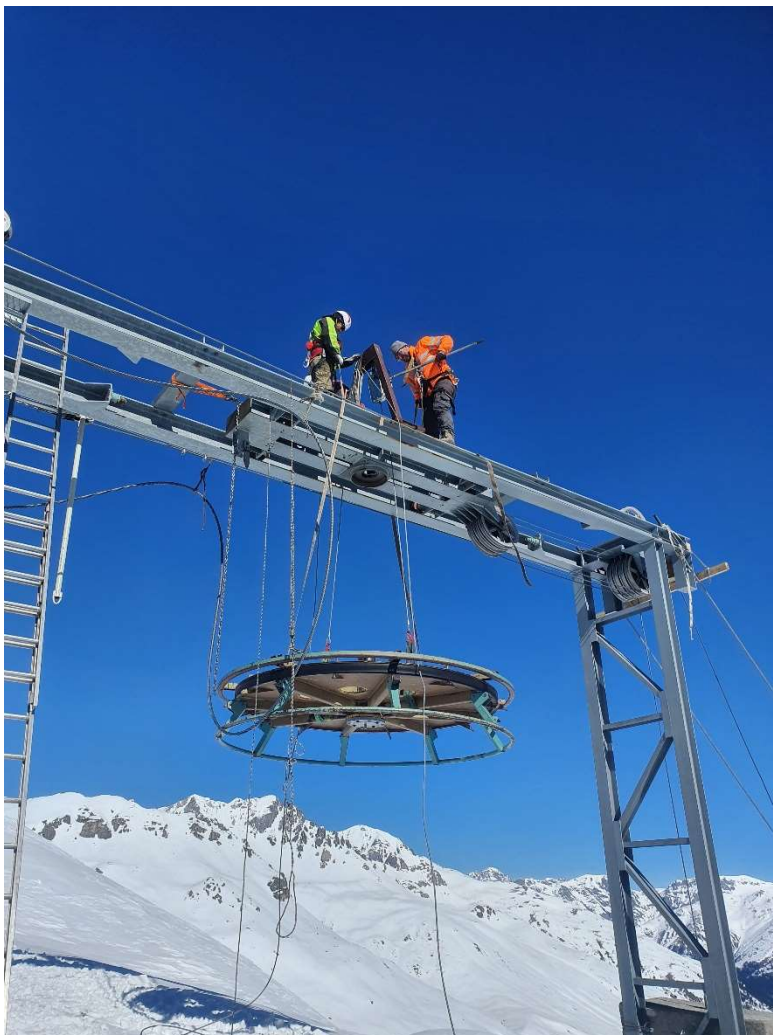
Demontage der Umlenkscheibe bei der Bergstation Minschuns (Foto: Sportanlagen AG Val Müstair).
